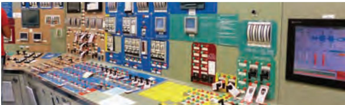
Sala de control
