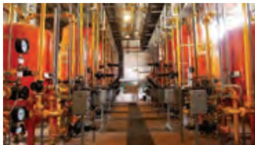
Interior del edificio de tratamiento de agua
