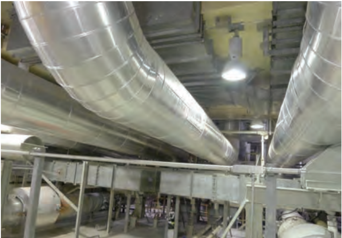
Tuberías de vapor principal
