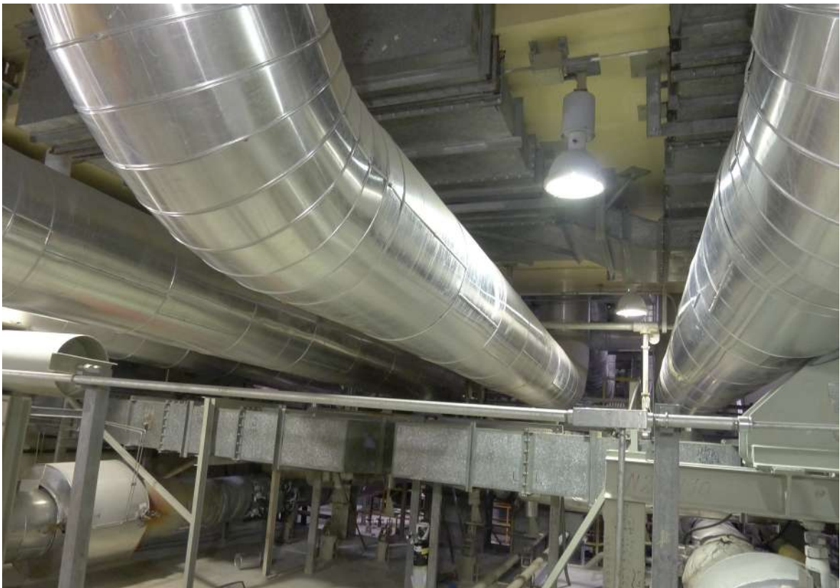
Tuberías de vapor principal
