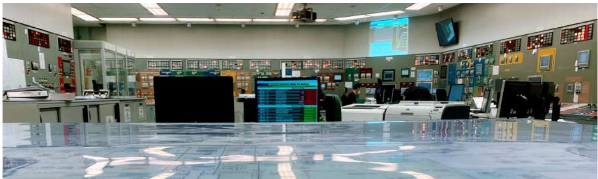
Sala de control
