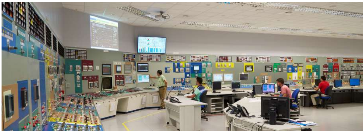
Sala de control
